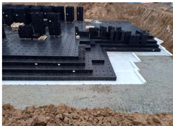
Foto: infiltratiesysteem als buffercapaciteit voor de infiltratie van regenwater.
