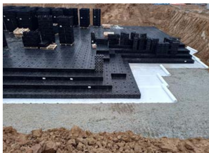
Photo : système d'infiltration offrant une capacité de stockage tampon pour l'infiltration de l'eau de pluie.
